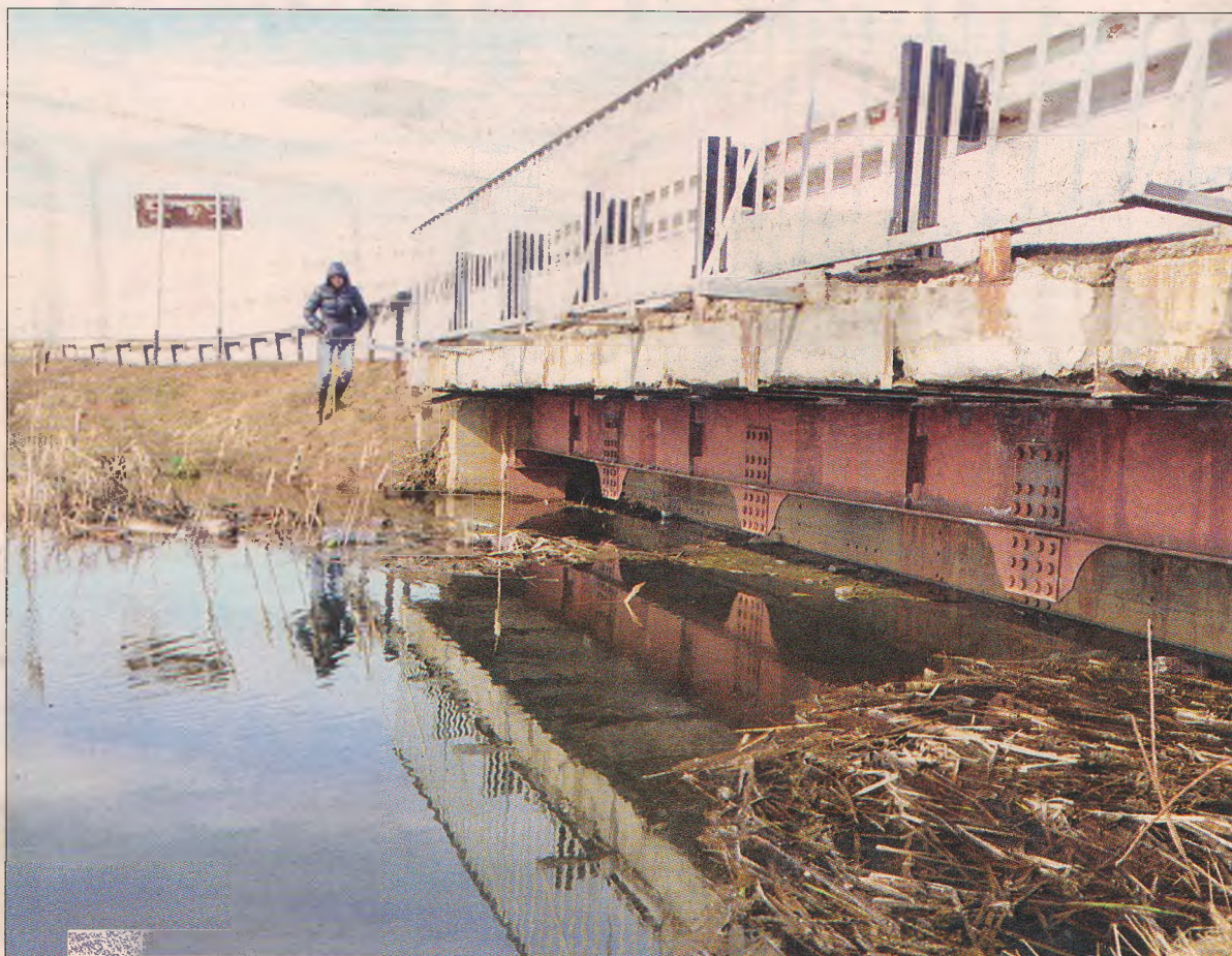
Балки моста на реке Ешке утопают в воде.
